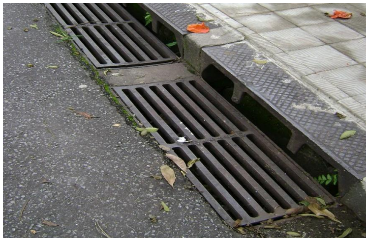
Figura 9 – Boca de lobo, componente do sistema de microdrenagem.
