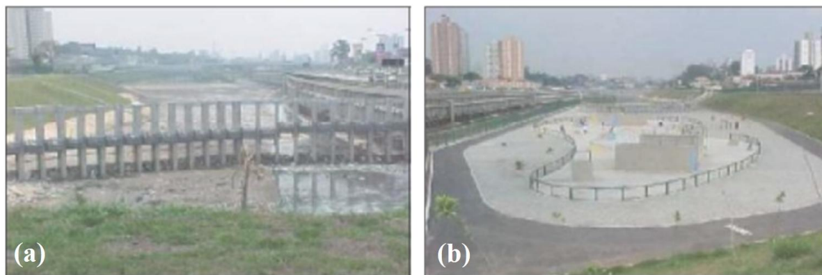
Figura 18 - Bacia de detenção em São Paulo, SP.
