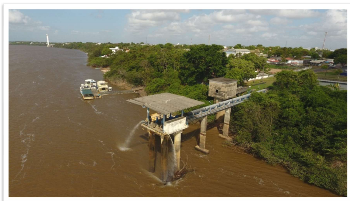
Figura 9 - Sistema de Captação Bruta Superficial da CAER
