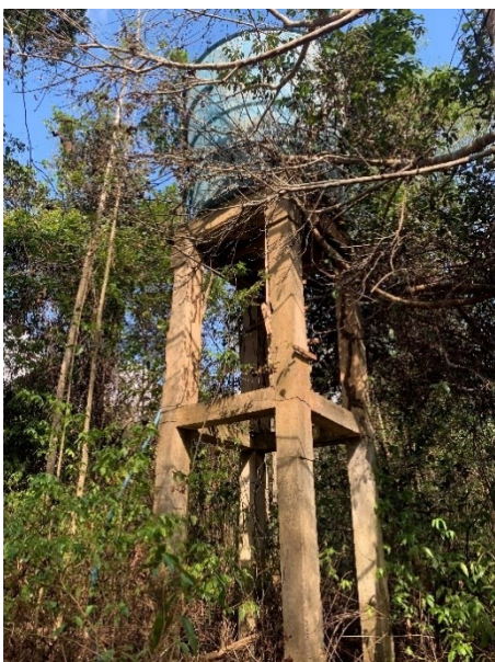
Figura 20 – Reservatório de água abandonado em Xixuaú
