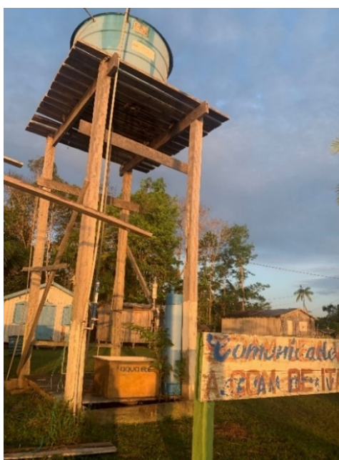
Figura 19 – Poço com filtro e dosador na Vila Itaquera
