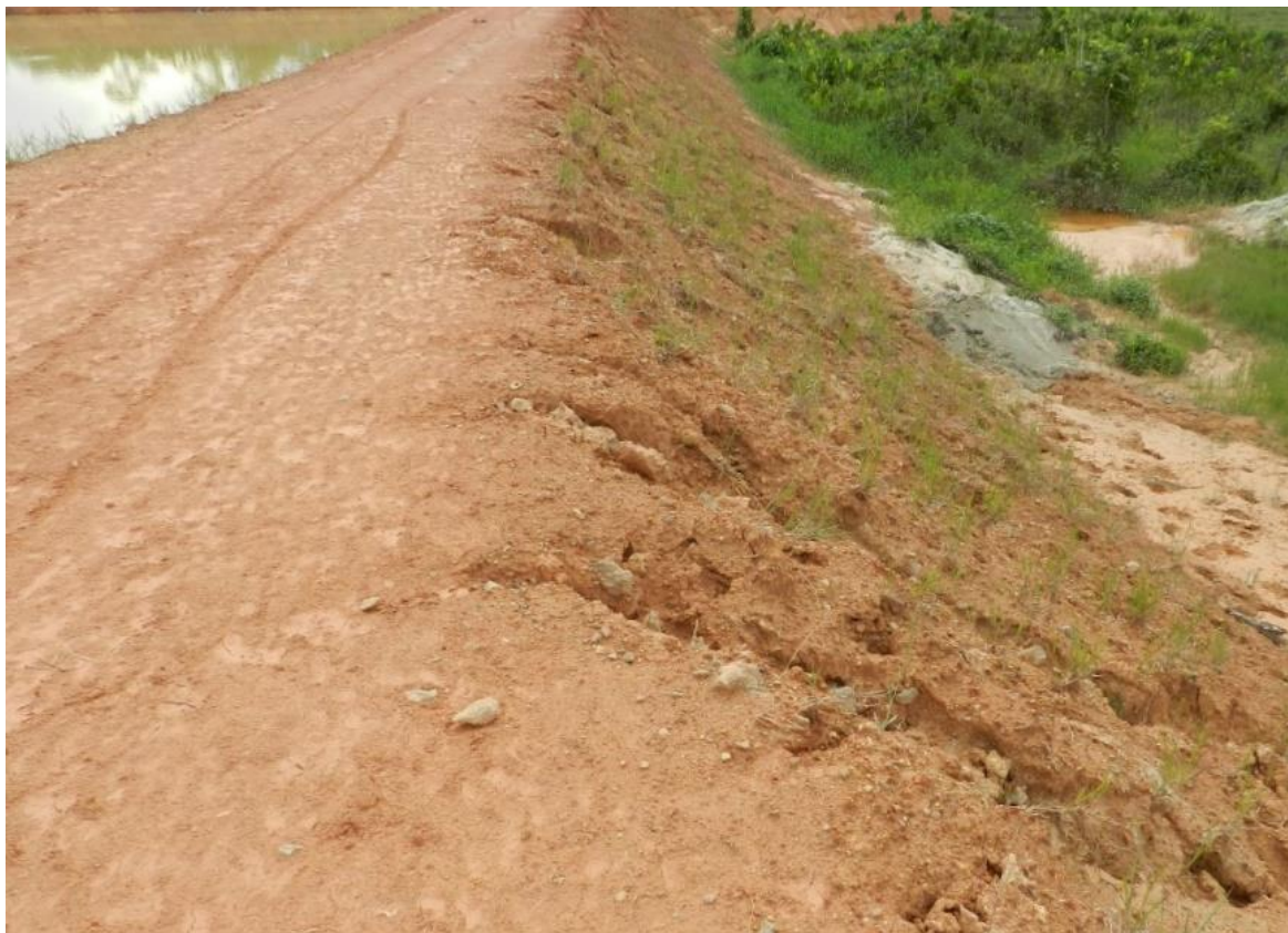
Figura 9 - Barragem fissuras em seus taludes a jusante na BH do Rio Cauamé
