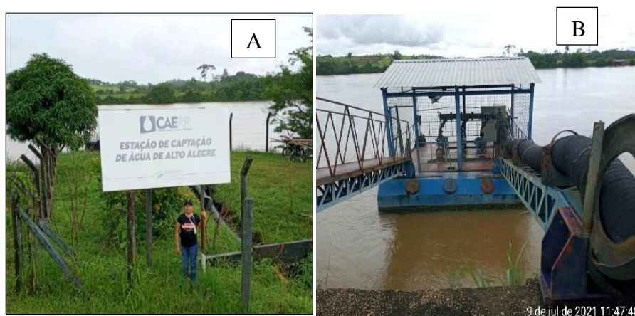
Figura 11 – Estação de captação de água na margem do rio Mucajaí (Figura A), balsa para o suporte de bombas (Figura B)
