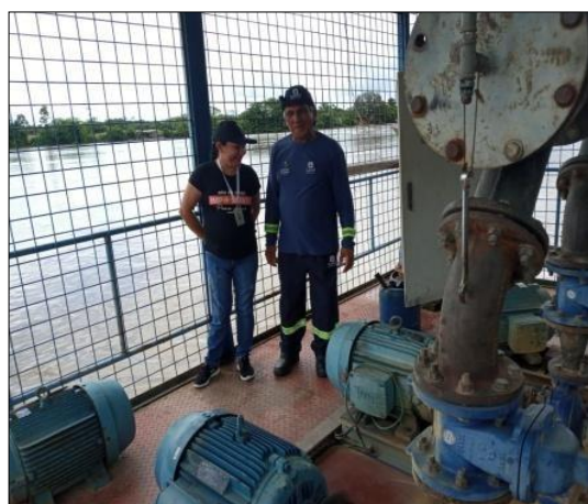
Figura 12: Bombas elétricas no interior da balsa da CAER da sede do município de Alto Alegre, Roraima
