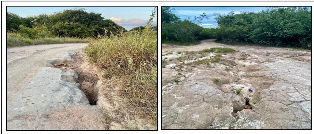
Figura 8 - Áreas com Processo Erosivo
